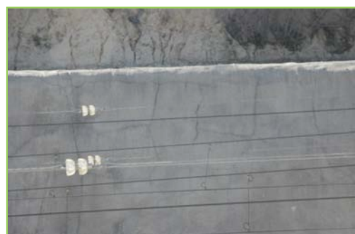
Detalle de gunitado fisurado
